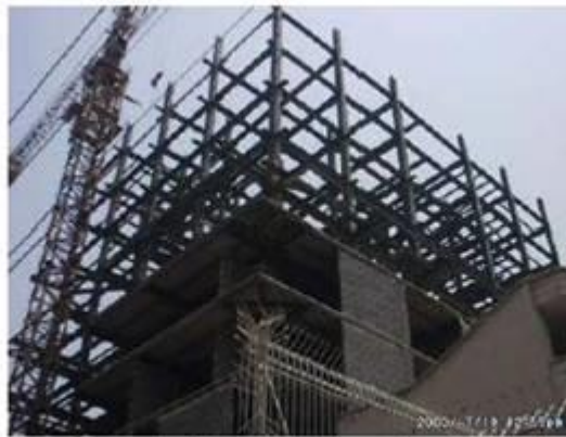
شکل ۲) عمده ساختمانهای بلند در تهران با اسکلت فولادی و اتصالات گیردار اجرا می‌شوند که نیاز به تأمین شرایط ویژه کنترل کیفی جوش دارند.
