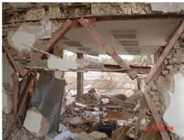
شکل ۴) خسارت لرزه‌ای وارد بر یک ساختمان فولادی در زلزله بم که پس از بریدن جوش اتصال عضو مهاربندی پدید آمده‌است.
